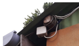
Une électricité très vétuste à rénover
